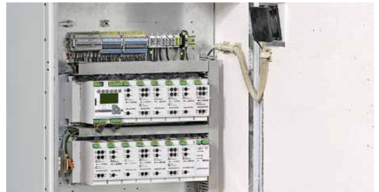
Abb. 2: Elektroverteiler für Sicherheitsbeleuchtungsanlagen mit einem Funktionserhalt von mindestens 30 Minuten im Brandfall
